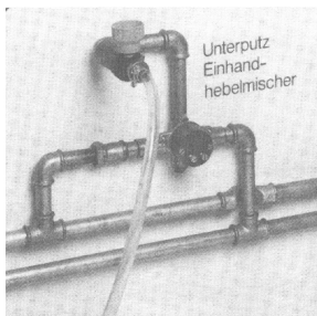
Ejemplo de montaje: Lavado de mezcladores de palanca (para una mano) empotrados.
