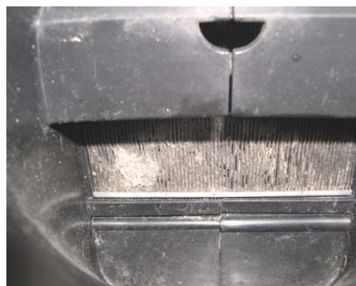
Photo du revers d'un tamis de filtre encrassé
